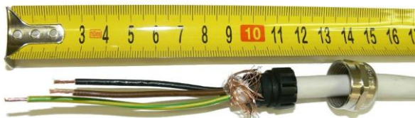
obr. 7 - ukončení silových kabelů
